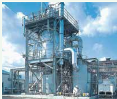
ASAHI PRETEC EHIME 공장 / 고온열분해장치
