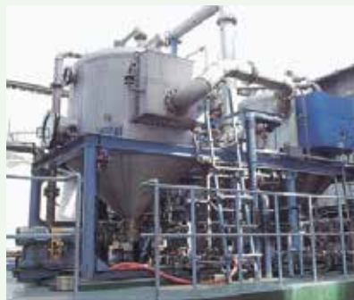
ASAHI PRETEC KOBE 공장 / 폐액농축장치
