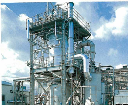
● Ehime 공장 / 고온열분해장치
